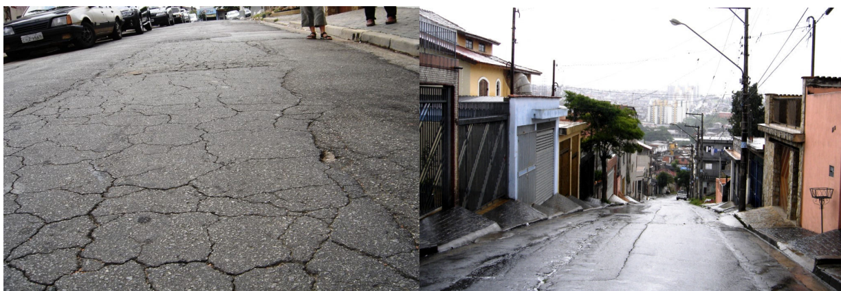
Figura 04: Ponto 9. Asfalto deteriorado, com trincas, devido a intensidade do escoamento superficial. Eduardo T. Nakamura, Fev/2006.
