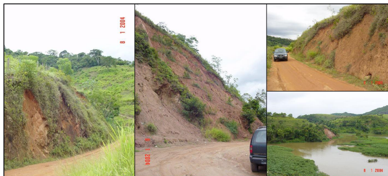
Figura 2: Seqüências de fotos mostrando diversas ocorrências de erosões nas margens do reservatório Morro Grande (08/02/2004).
